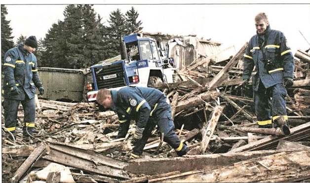
ERST ÜBUNG, DANN ABRISS: Auf der Hornisgrinde probte das Technische Hilfswerk am Wochenende den Ernstfall. Das vom Einsturz bedrohte ehemalige Casino wurde danach abgebrochen. Foto: dms
